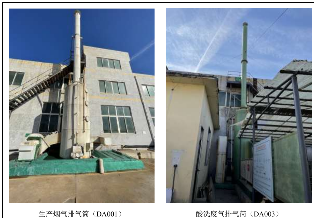
图 4.1-1 废气治理措施照片
